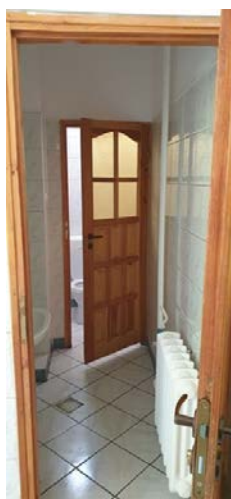
Zdj. 10. Widok toaletę na piętrze
